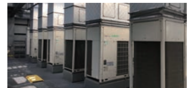
住友不動産六本木グランドタワービル用マルチエアコン室外機
