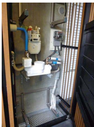
<室外機他格納スペース>
